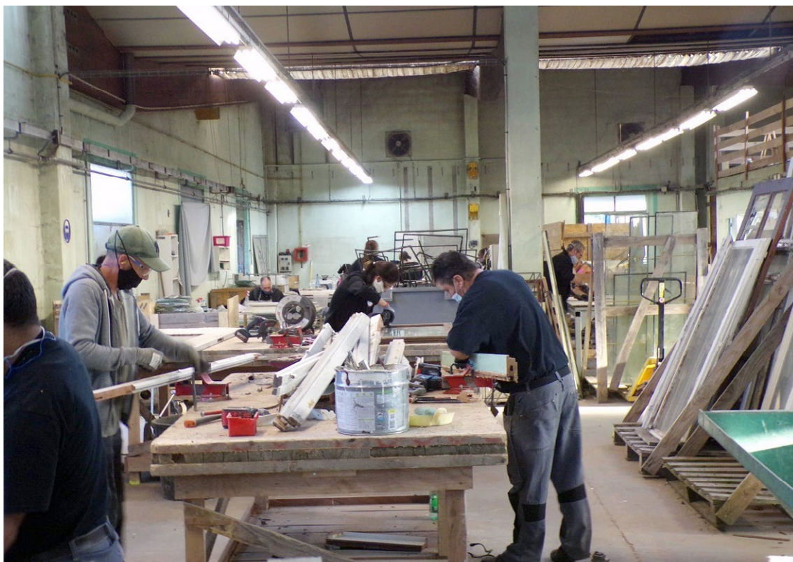
Visuel 02: Travail de démantèlement à l'ESIAM: séparation du verre, du bois, du mastic, et du métal.
